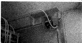
冬期、新トンネル換気区分コントロールを行なう入気口駆動装置。停電時舎内が一定温度以上になると自動開放し、停電が回復すると元の位置に戻るよう改良が進んでいる
